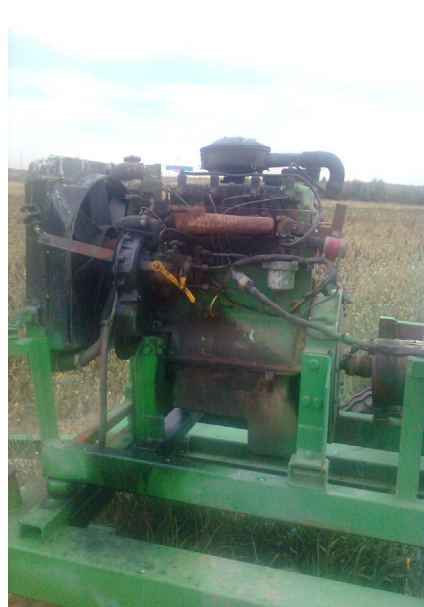
Figura 15: Grupo bombeo Vega de Infanzones
